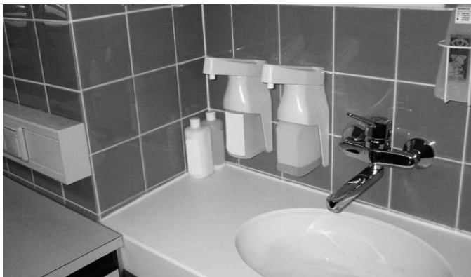
Beispiel eines Händewaschplatzes (Hinweis: Auswahl zufällig; auch vergleichbare Desinfektionsmittelspender und Einhebel-Armaturen sind geeignet).
